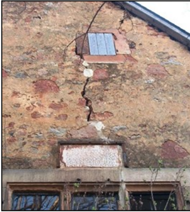
Breite Mauerrisse im Nordgiebel
