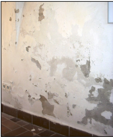
Aufsteigende Nässe in der Westwand verursachte Schäden am Innenputz
